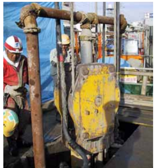
写真 - 3 . ポンプ吐出配管
