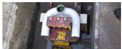
写真 - 4 . ポンプ吐出口
