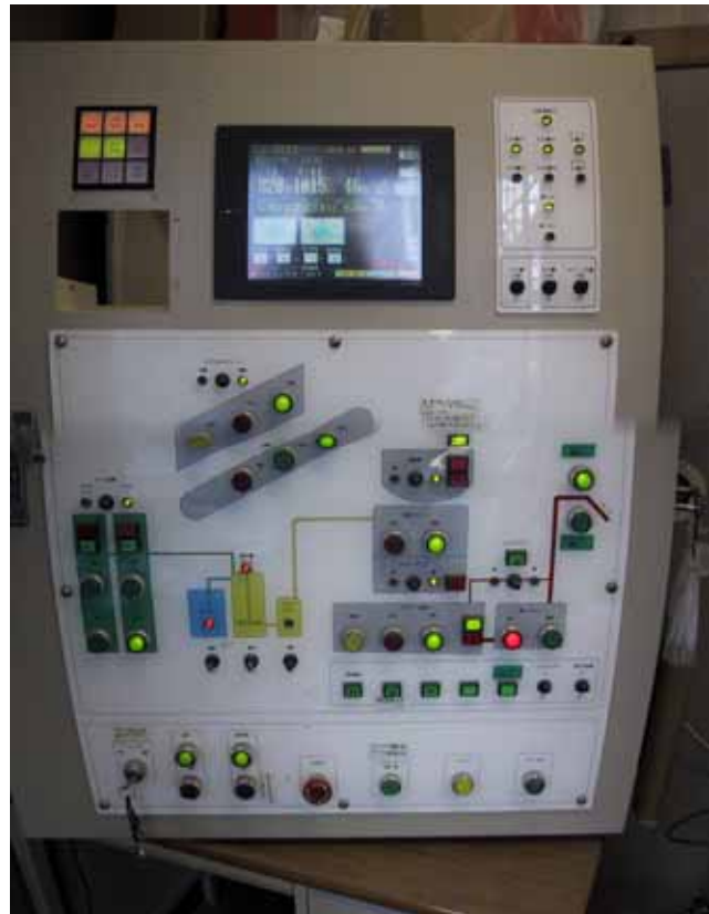
写真 - 1 . 泥土モルタルプラント集中操作盤
